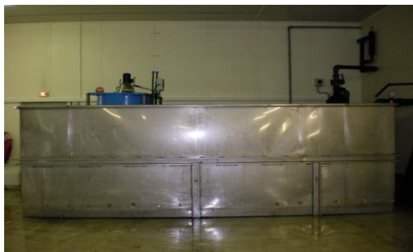
Cuve de réserve
